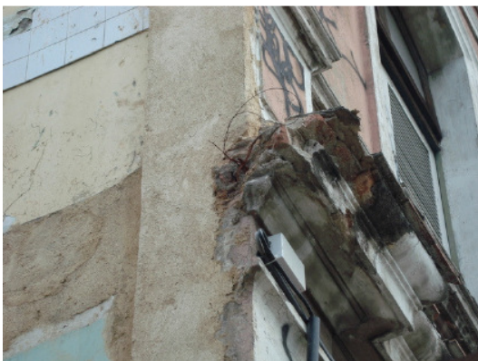
Fachada do prédio 7A a ser refeita
