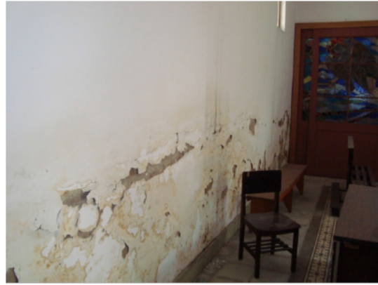
Interior da capela com umidade nas paredes
